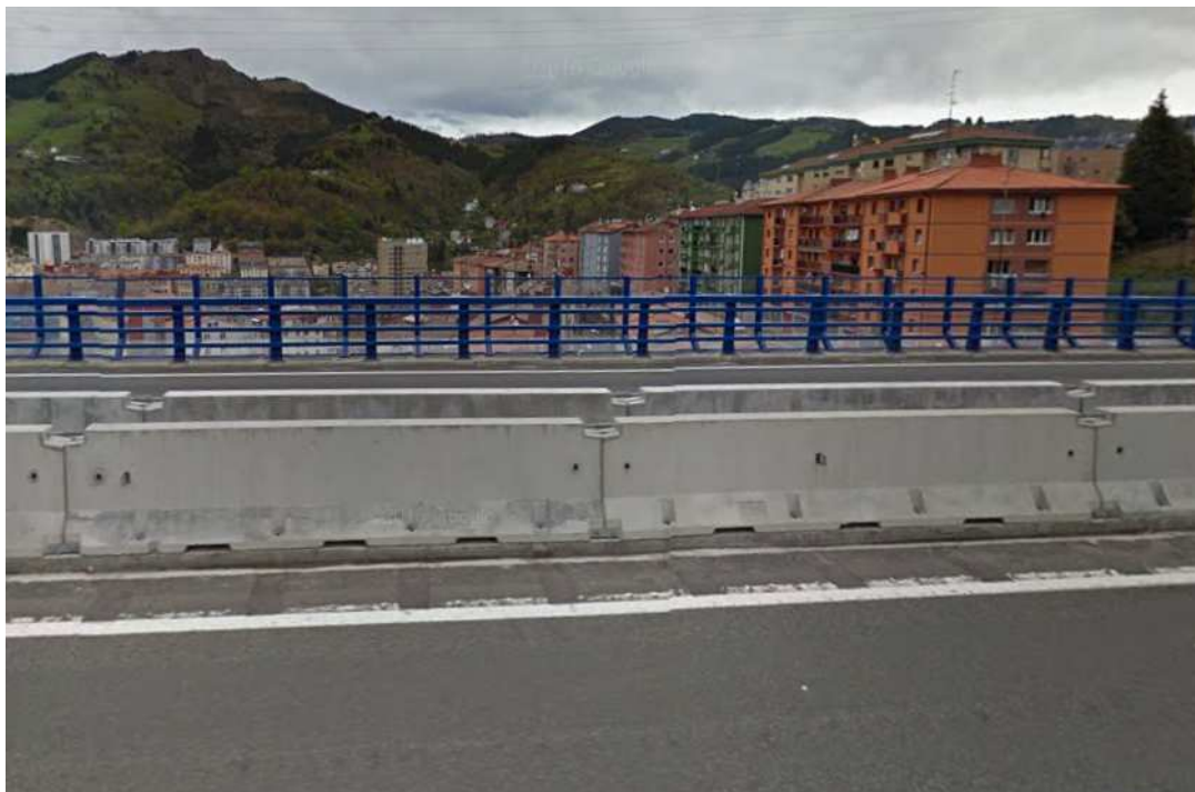
Segundo viaducto de la traza a su paso por Eibar, que cuenta con una pantalla acústica
