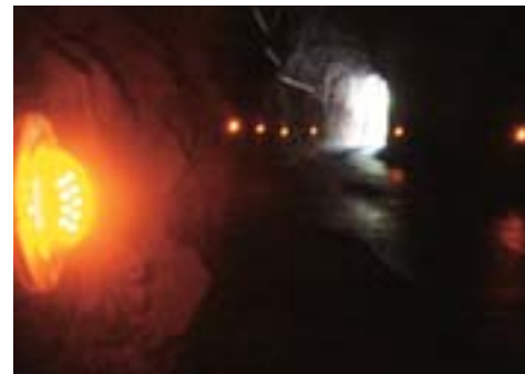
• Balizas de guiado en el túnel de una vía ciclista (Leitzarain).
